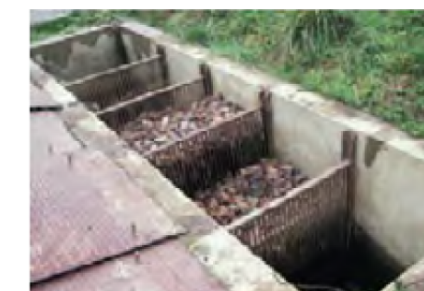
Filtre fixe installé sur une eau close (hors d'un cours d'eau)
